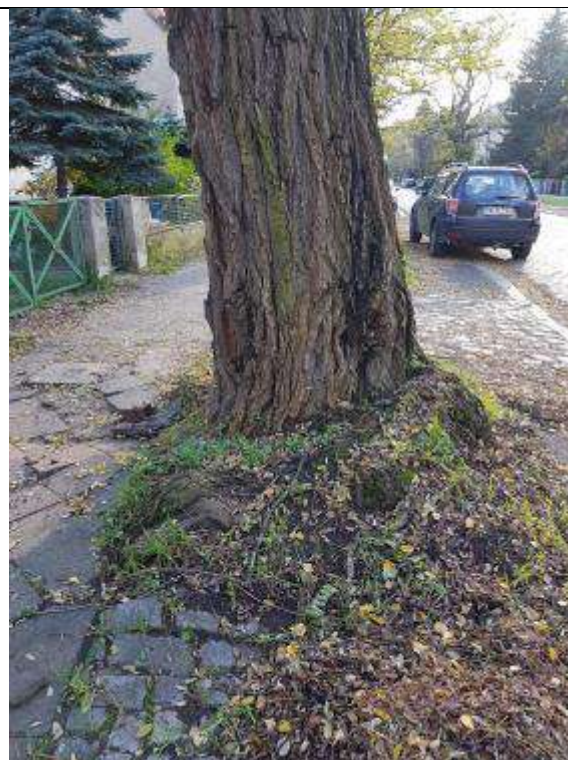
Fot. 2 Robinia 29-9, ul. Odkrywców 26-28, Wrocław. Korzenie podnoszą płytki chodnika.
