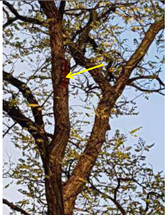
Fot. 6. Robinia 33-18, ul. Odkrywców przy parku, Wrocław. Ślad po wytamanym konarze.
