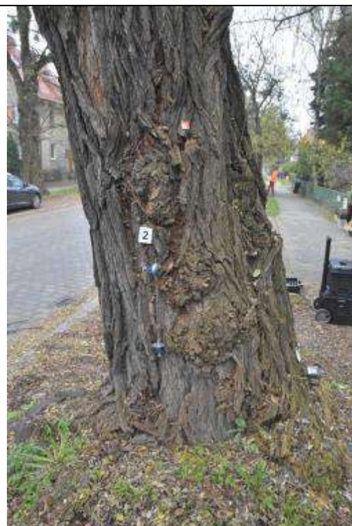
Fot. 8. Robinia 43-29, ul. Odkrywców 15, Wrocław. Próba obciążeniowa - miejsce mocowania czujników – strona rozciągana
