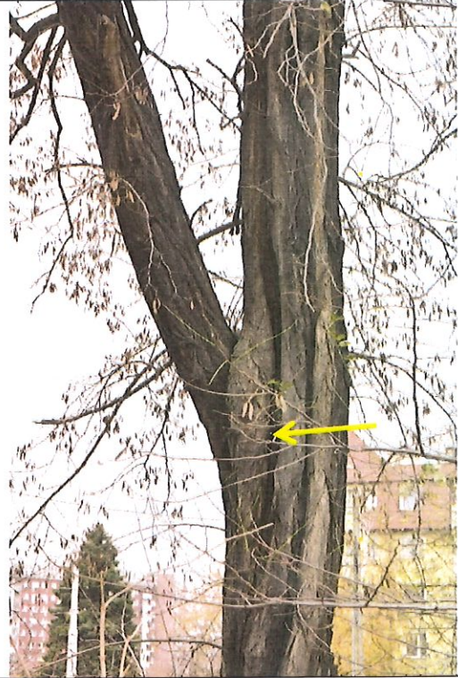
Fot. 4. Grupa robinii, ul. Zawalna, Wrocław. Pęknięcie u podstawy konaru (na przestrzał pnia).
