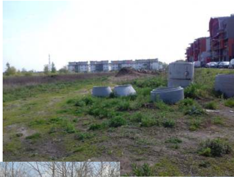
Pozostałości po budowach
