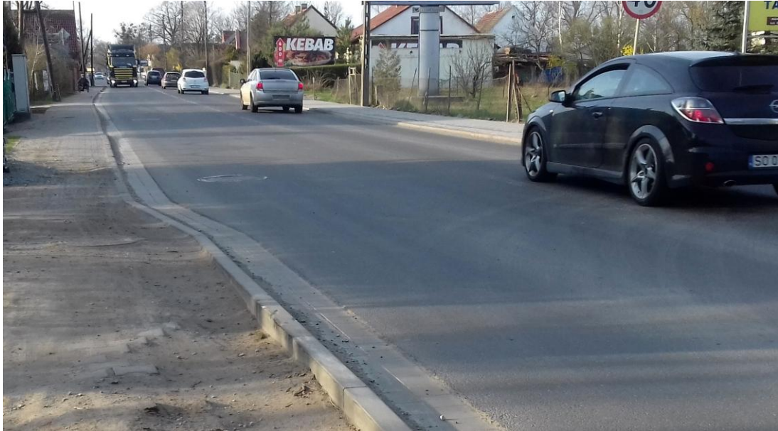
Fot. 9-13. Bardzo wąski i zniszczony chodnik na ul. Pełczyńskiej na odcinku między ul. Kominiarską i ul. Szczawiową, szerokie pasy jezdni
